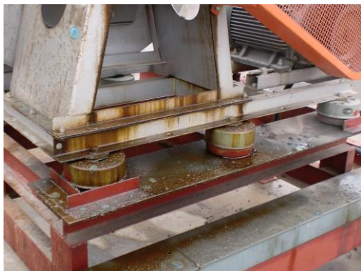
矿物油泄漏—整改前
