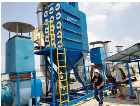
滤筒式除尘器采样孔及采样平台
