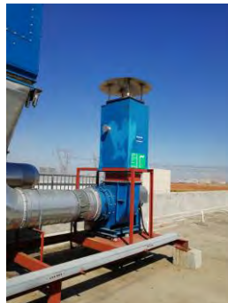
除尘器排气口编码
