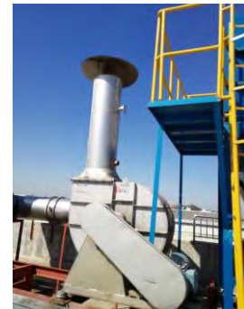
泡沫式洗涤塔采样孔及采样平台
