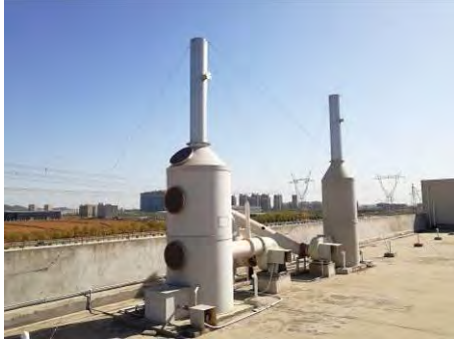
实验室洗涤塔排气筒
