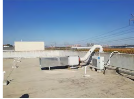
实验室活性炭吸附装置排气筒
