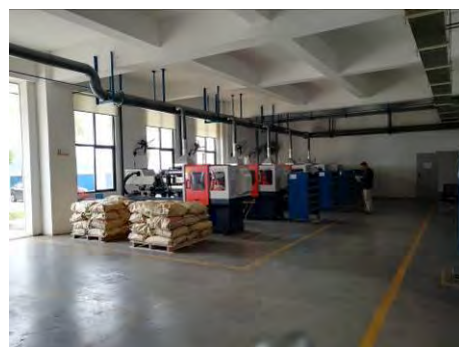
注塑机机头收集装置及通风管道
