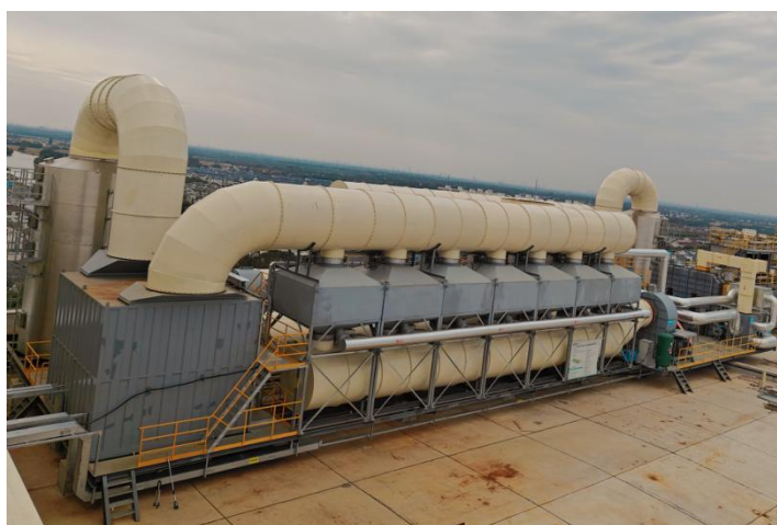
VOCs 废气治理项目
